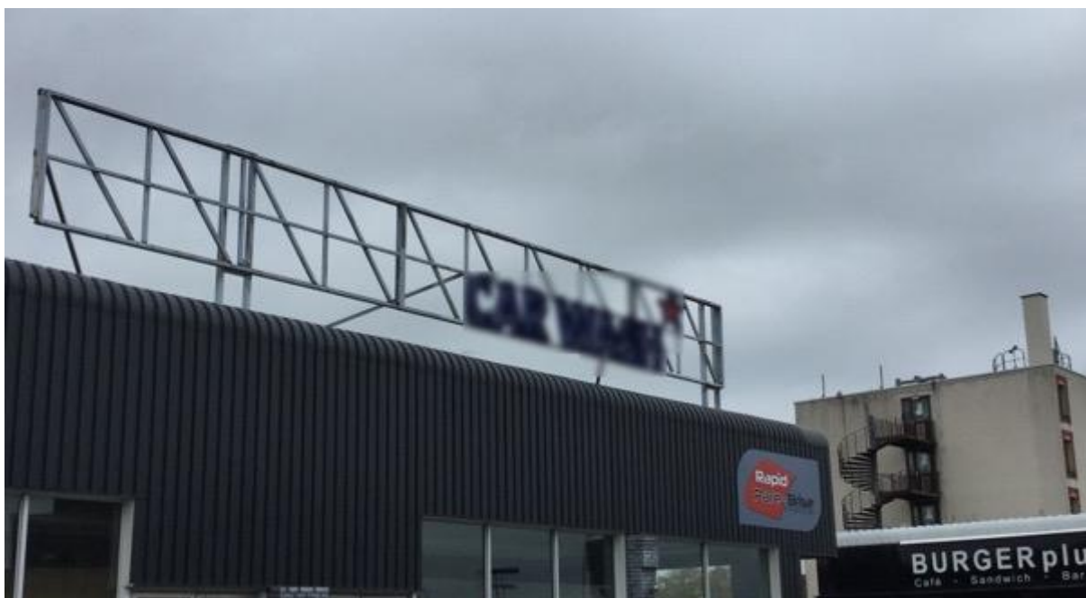
Enseigne sur toiture avec fixations non dissimulées (non conforme), Coignières, 2017
