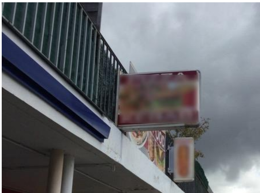
Enseigne perpendiculaire sur un balcon (non conforme), Villepreux, 2017
